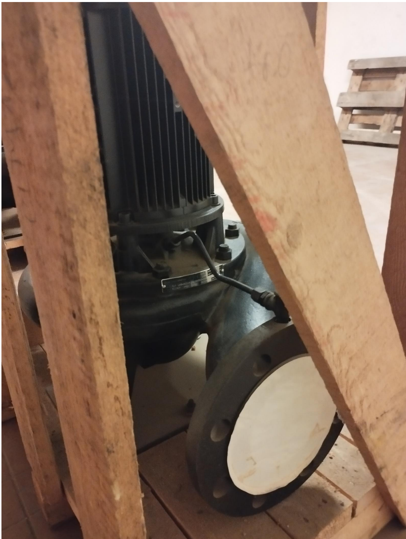
Fotografie čerpadla č.3
