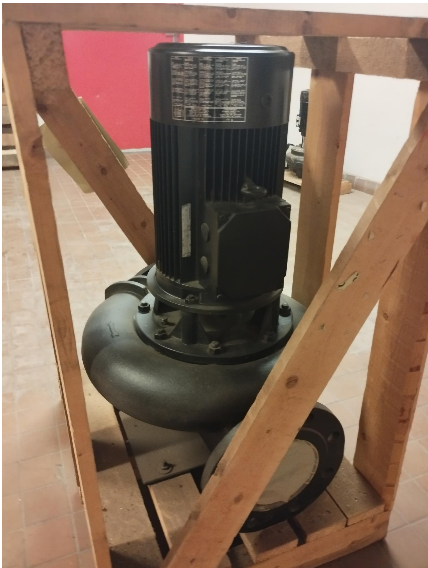
Fotografie čerpadla č.2
