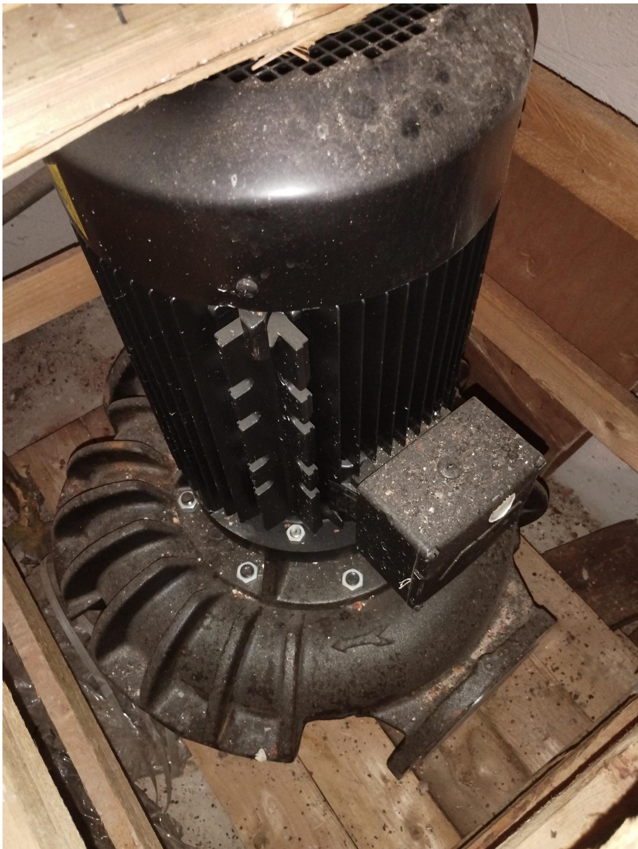
Fotografie čerpadla č.1
