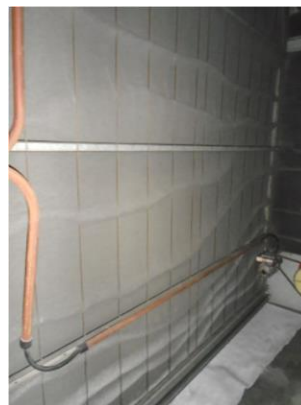
Obrázek 4 – Pohled na filtr
