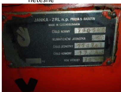
Obrázek 20 – Štítek komory ventilátoru
