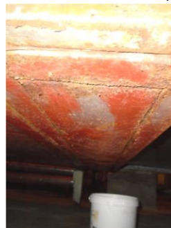
Obrázek 17 – Pohled na korozi podlahy s netěsnostmi
