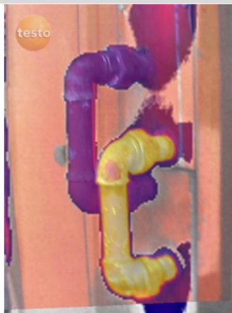
Obrázek 32 – Teplotní spád při měření výkon dohříváče
