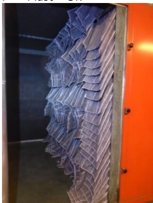
Obrázek 5 – Pohled na skladbu kapsových filtrů
