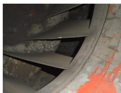
Obrázek 21 – Pohled do komory ventilátoru
