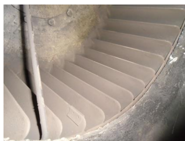
Obrázek 10 – Pohled do komory ventilátoru
