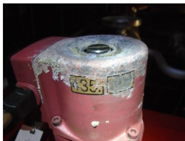
Obrázek 8 – Oběhové čerpadlo ohřivače
