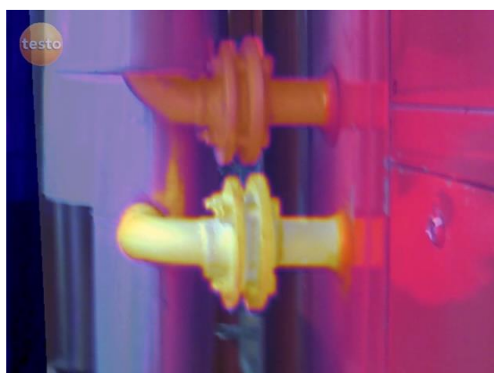
Obrázek 29- Teplotní spád při měření výkonu dohříváče
