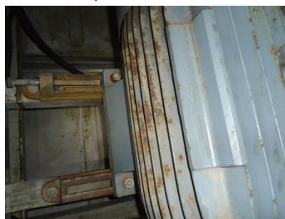
Obrázek 22 – Pohled do komory ventilátoru
