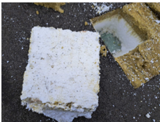
Foto /60/ Pohled na EPS ze skladby, bez známek degradace
