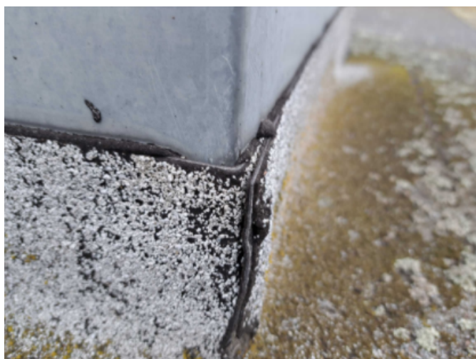
Foto /44/ Silně zdegradovány asfaltové hydroizolační pásy ve vytažení na prostupy
