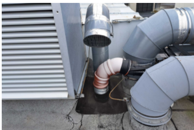
Foto /36/ Nesprávně zvolen ochranný prvek z kanalizačních trubek z PVC
