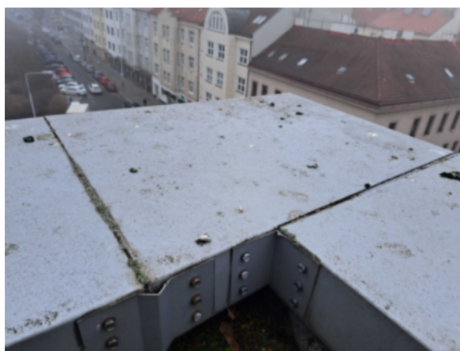
Foto /16/ Roh oplechování atiky, znatelné nesoudržné a zdegradované plechy
