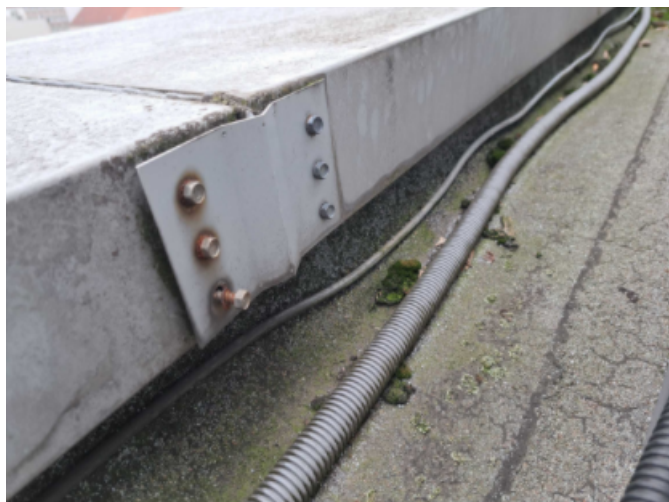
Foto /19/ Spoj oplechování atiky s korozí
