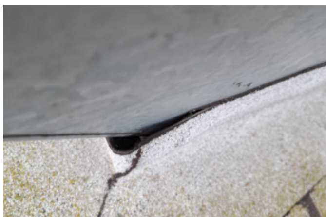
Foto /35/ Nesoudržnost hydroizolace s podkladem ve vytažení,
