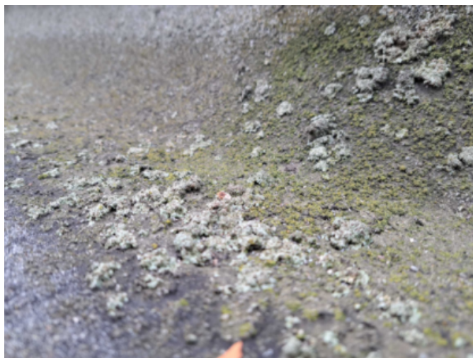
Foto /8/ Tvorba lišejníků a mechů v ploše střechy
