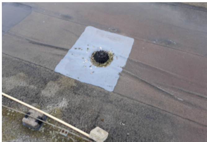
Foto /6/ Tvorba rozsáhlých louží a vrás v okolí mírně zaneseného vtoku
