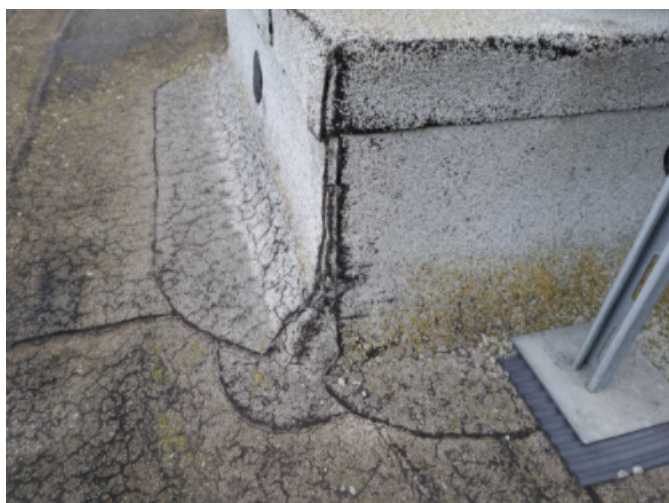
Foto /43/ Silně zdegradovány asfaltové hydroizolační pásy ve vytažení na prostupy
