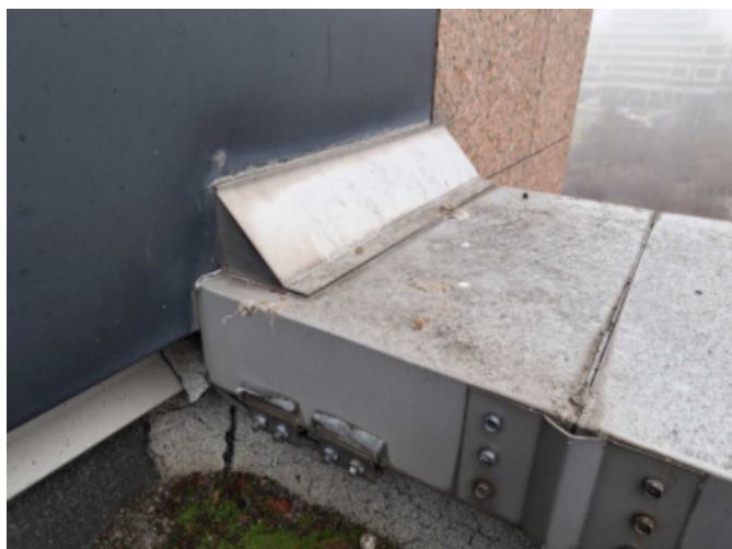
Foto /17/ Napojení oplechování atiky na fasádu
