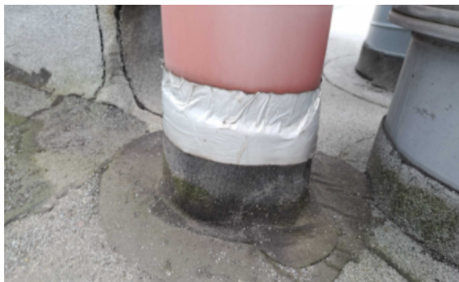
Foto /39/ Nefunkční oprava prolepením nesoudržného vytažení hydroizolace a podkladního materiálu
