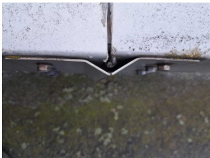
Foto /18/ Nesoudržný spoj oplechování atiky
