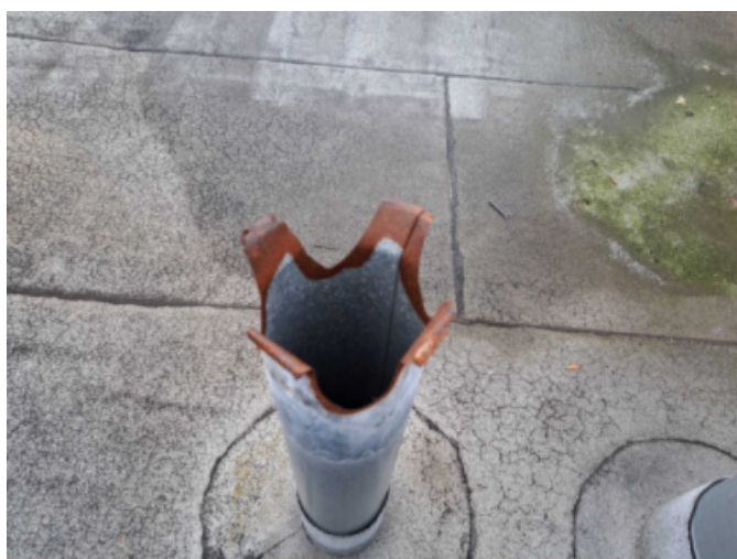
Foto /29/ Absence hlavice vlivem mechanického poškození
