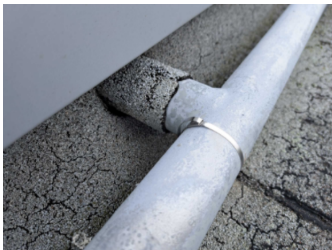
Foto /54/ Napojení záchytného zařízení pro umývače oken na atiku
