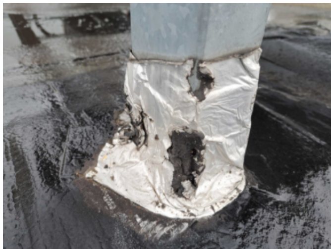
Foto /26/ Detail mechanicky poškozené prostupující konstrukce, pravděpodobně také způsobeno umývači oken
