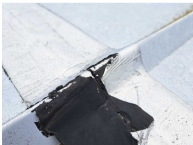
Foto /22/ Nefunkční a zvětraná oprava spoje oplechování prolepením
