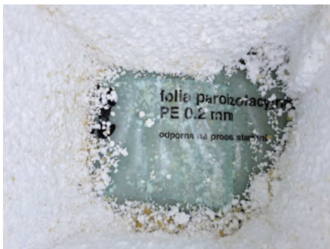
Foto /63/ Pohled na parotěsnicí fólii v sondě S4
