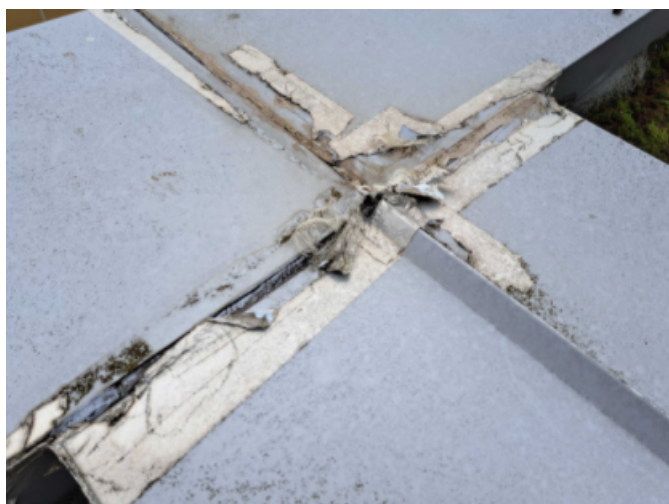
Foto /21/ Nefunkční a zvětraná oprava spojů oplechování prolepením
