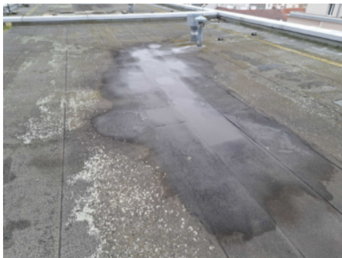
Foto /1/ Tvorba rozsáhlých louží v ploše střechy
