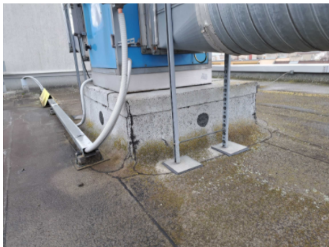
Foto /42/ Podpěry správně položeny na přířezech
