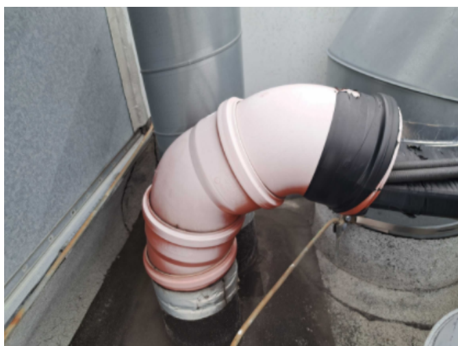
Foto /37/ Nesprávně zvolen ochranný prvek z kanalizačních trubek z PVC
