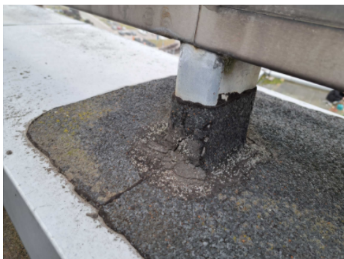
Foto /23/ Prostup konstrukce billboardu skrz atiku
