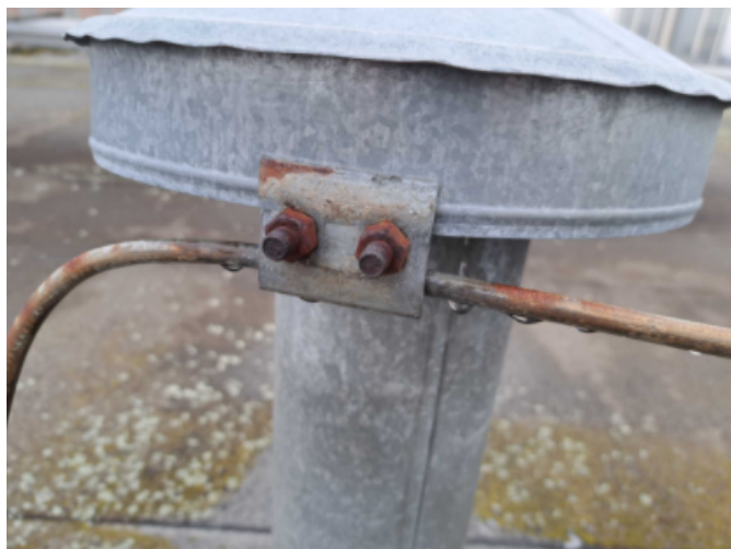
Foto /50/ Uchycení hromosvodu ke komínovým hlavicím, znatelná silná koróze
