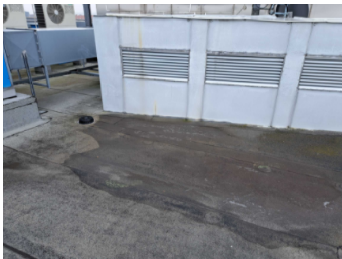
Foto /2/ Tvorba rozsáhlých louží v ploše střechy v blízkosti vtoku
