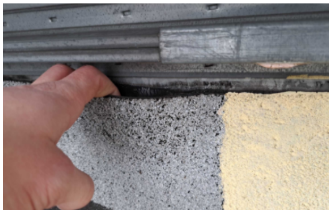
Foto /27/ Vytážení hydroizolace na prostupující konstrukci, izolace nesoudržná s podkladem
