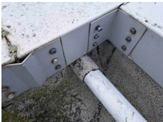
Foto /53/ Napojení záchytného zařízení pro umývače oken na atiku
