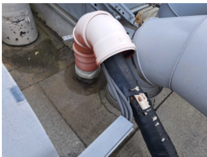
Foto /38/ Nesprávně zvolen ochranný prvek z kanalizačních trubek z PVC
