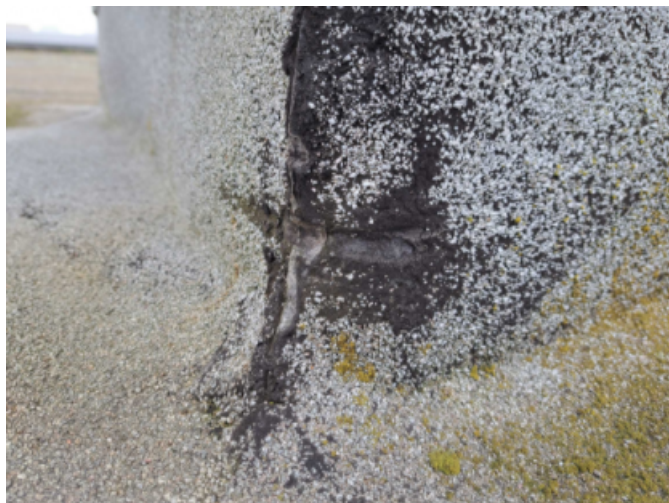
Foto /25/ Detail mechanicky poškozené hydroizolace od umývačů oken, způsobeno nesprávným uchycováním se za pomoci lana o prostupující konstrukci
